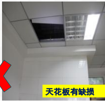
天花板有缺损
